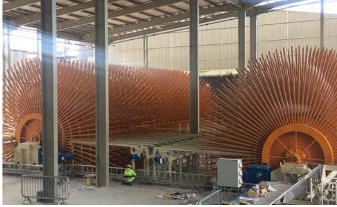
Kühl- und Abstapelstation hinter der Presse: die Kühlsterne werden montiert
