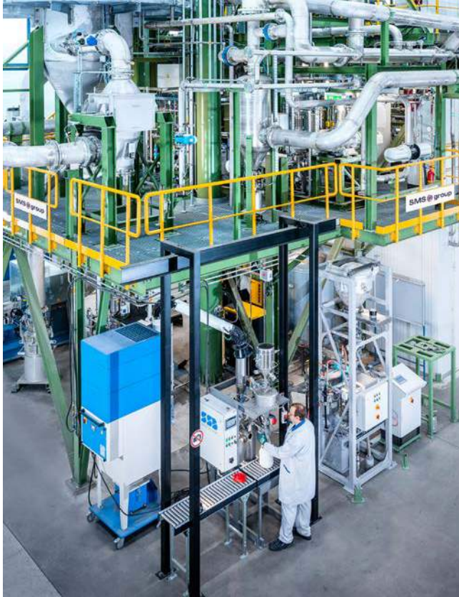
Prototyp der Pulververdünnungsanlage in Mönchengladbach
