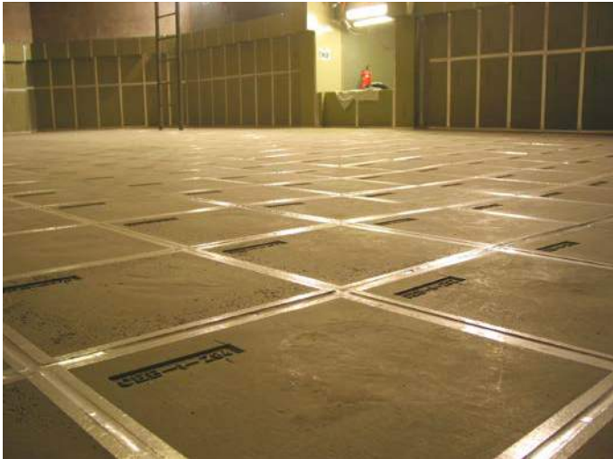
KSI montierte den allerersten Core Catcher, eine Sicherheitsbarriere für den Kernkraftwerksreaktor
